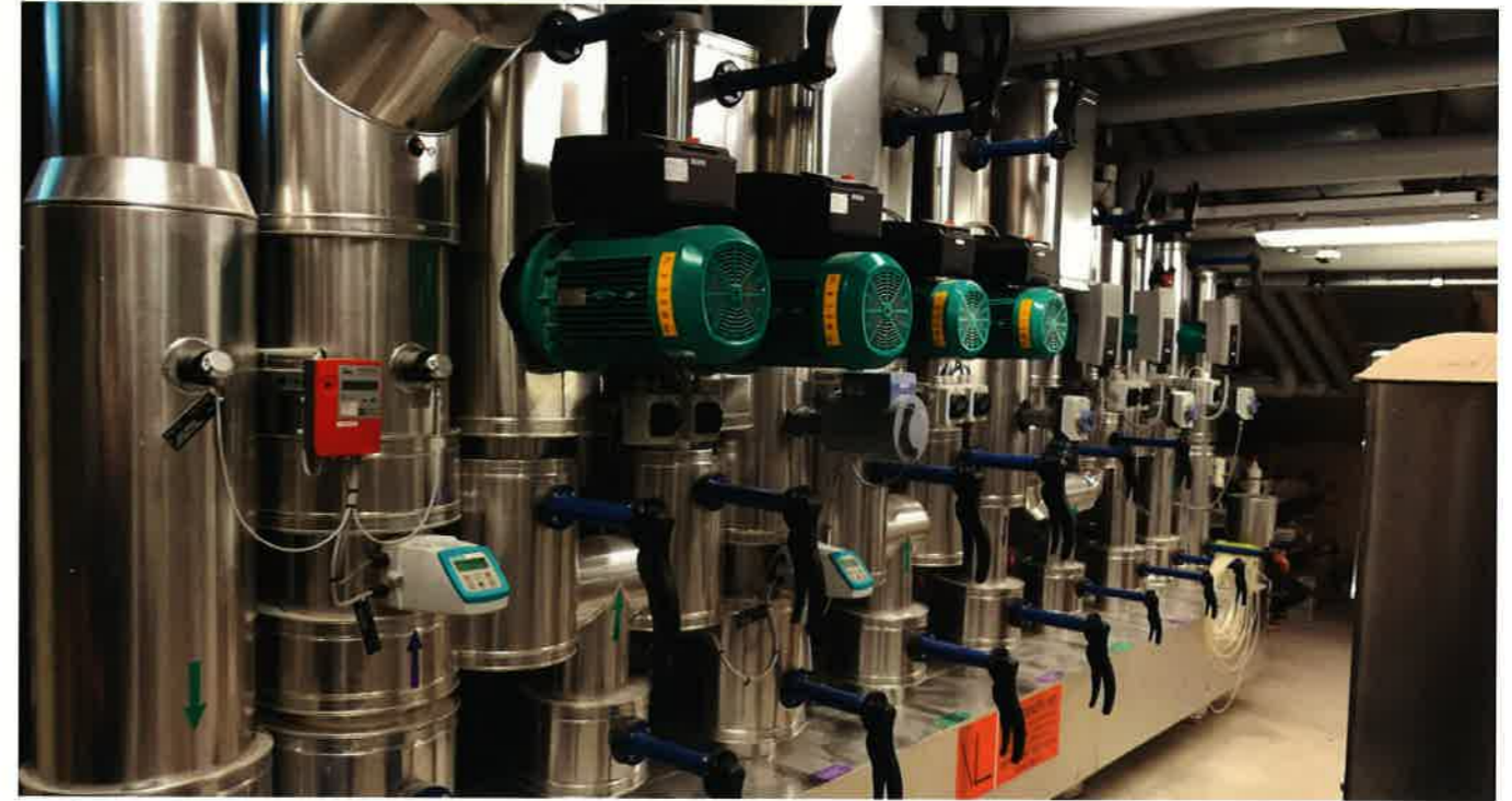
Centrale impianti termici
